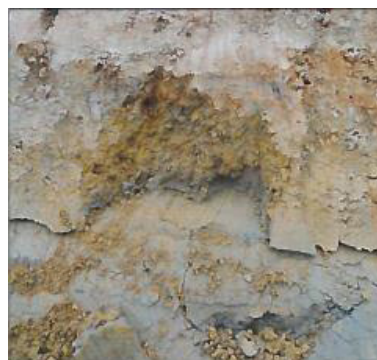
Obr. 6: Obnažená smyková plocha slínovcích. [13]
