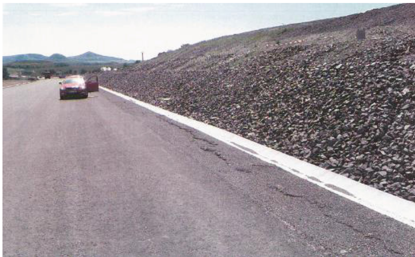
Obr. 2: Začínající tahové trhliny vznikajícího sesuvu v krajnici vozovky spodního jízdního pásu pod spodním svahem zářezu. Pohled na sever. 5. června 2013 12:42 hod. [6]
